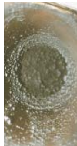
Moisissures dans une gaine d'extraction
